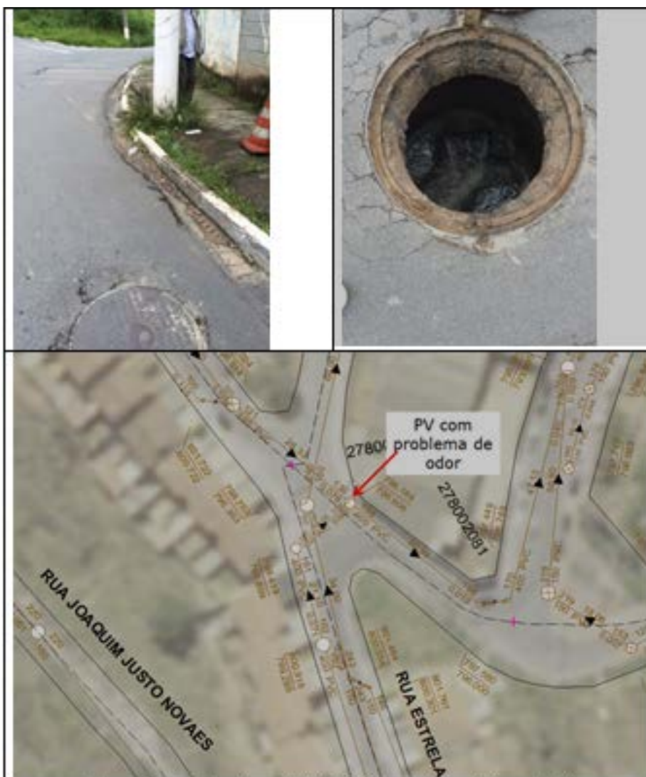
Figura 1: Fotografias e planta do SIG do PV com problema de odor em Cotia.
