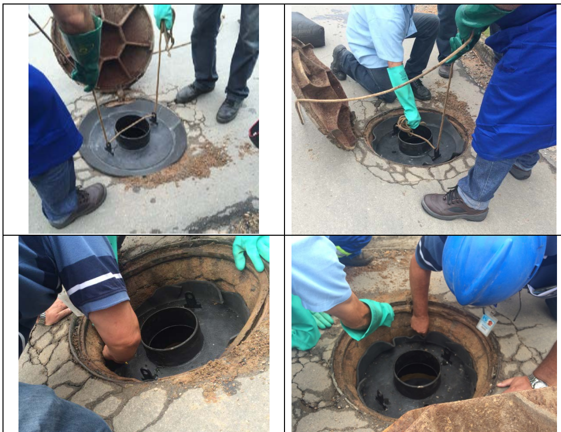
Figura 5: Fotografias da instalação do da Coluna de CA no PV de Cotia.
