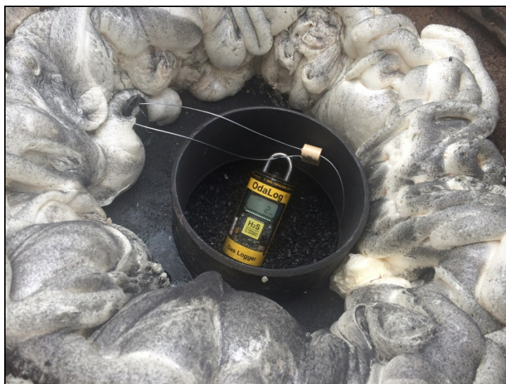
Figura 4: Analisador ODALOG instalado na chaminé do PV, preso com lacre de aço, registrando os valores de concentração de H 2 S ao longo do tempo.
